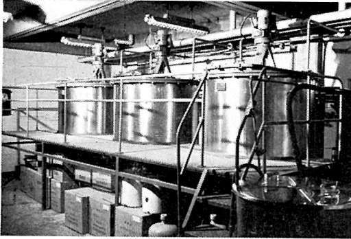
仕込みタンク
