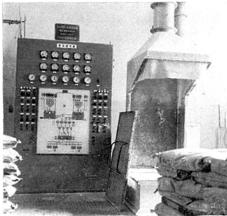
混合機操作盤
