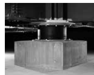
東日本大震災の教訓より従業員の安全性やBCP（事業継続計画）を考慮し、第一工場生産棟には免震装置を設置している。
