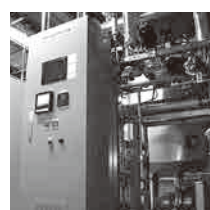
EDIシステム (精製水製造供給装置)
